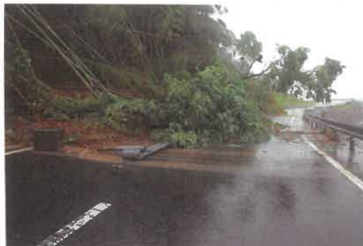
【法面崩壊（平成30年7月豪雨）】
