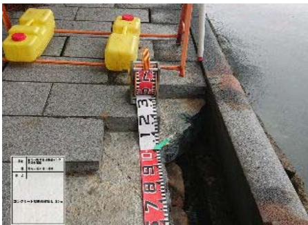
護岸の空洞化
