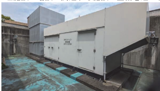
非常用発電設備（増設）
