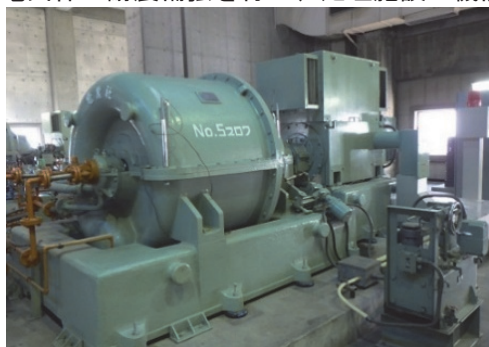
送風機設備（更新）
