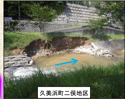
久美浜町二俣地区 平成29年台風18号による被害 『浸水家屋 18戸、浸水面積 約100ha』
