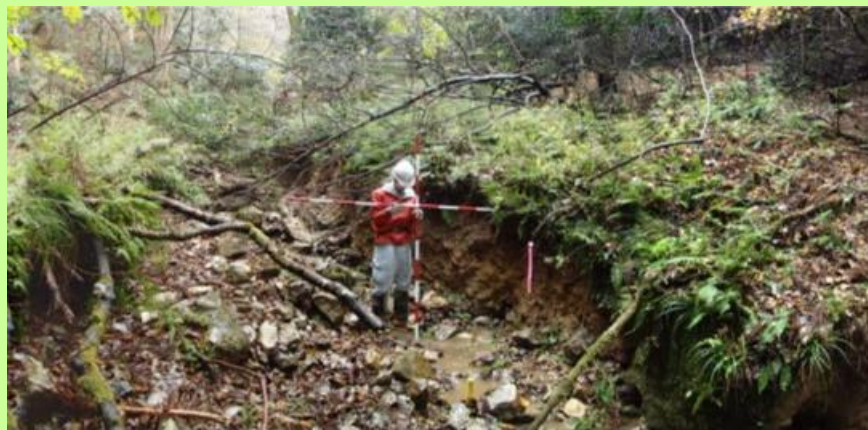
溪流荒廃状況
