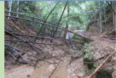
危険木の撤去（実施前）
