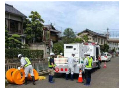
排水ポンプ車
