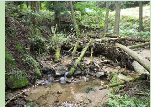
危険木の撤去(実施前)
