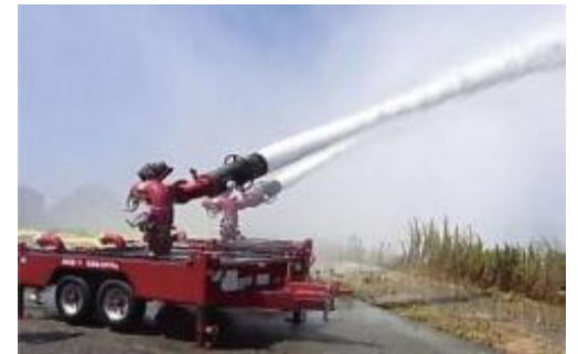
【屋外放水設備】
