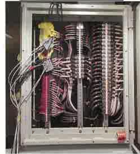
端子箱写真 (A方向を撮影)
