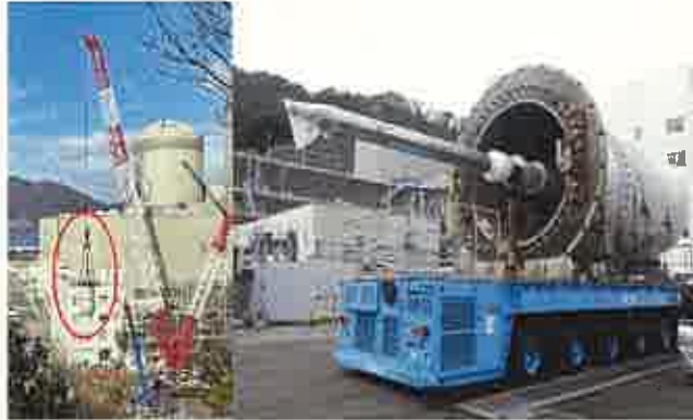
【②再稼動前点検】 工場保管していた循環水ポンプの 据付け作業
