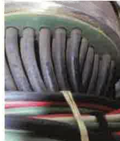
端子箱内写真 (カメラを挿入しB方向を撮影)
