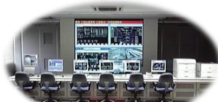
広域浄水センター（水運用）
