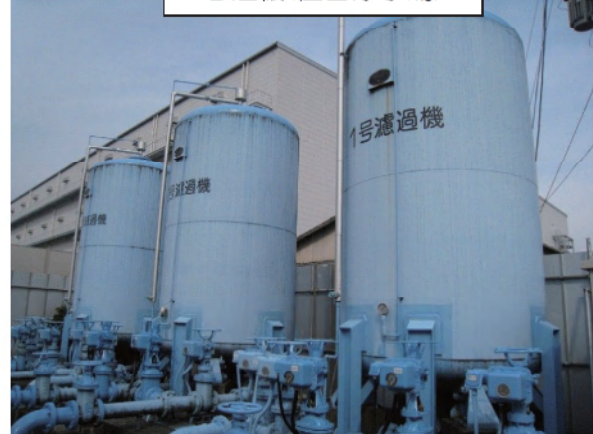
ろ過機(佐古浄水場)
