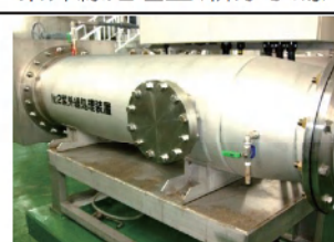
紫外線処理室(薪浄水場)
