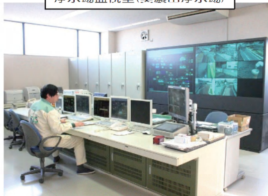
浄水場監視室(美濃山浄水場)
