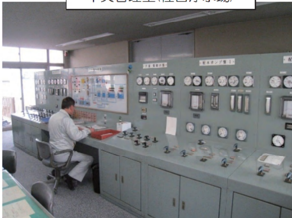
中央管理室(佐古浄水場)
