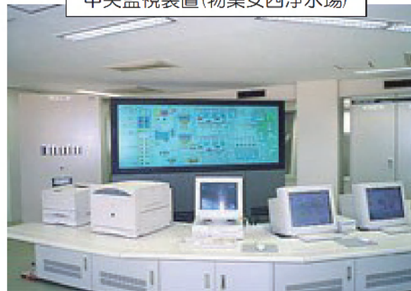
中央監視装置(物集女西浄水場)
