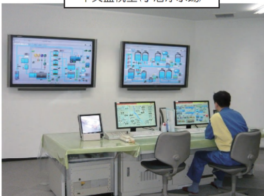
中央監視室(宇治浄水場)
