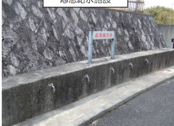
応急給水施設
