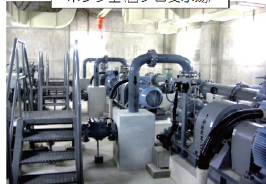
ポンプ室(宮ノ口受水場)
