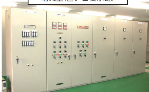
電気室(宮ノ口受水場)
