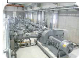
久御山広域ポンプ場
