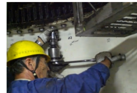
写真1 タワートップボルト緩み確認
