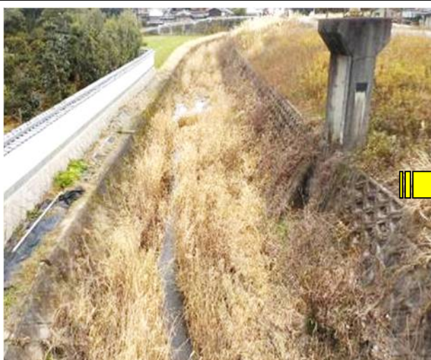
土砂が河川を阻害しており危険
