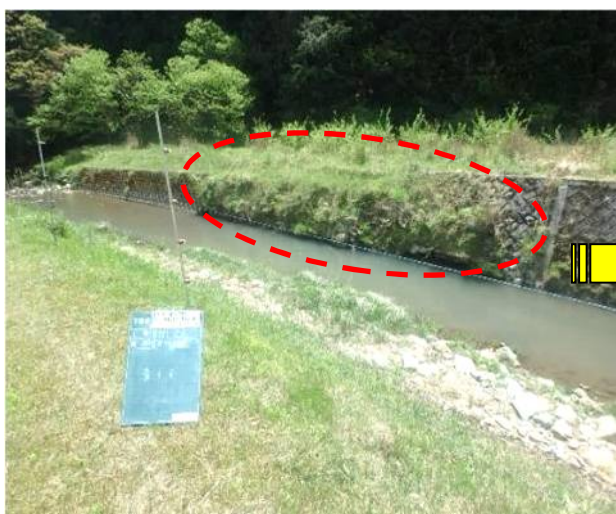
河川護岸が崩れかけており危険
