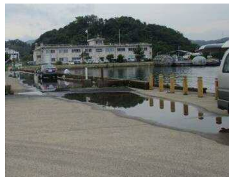
□舗装が沈んでいる
