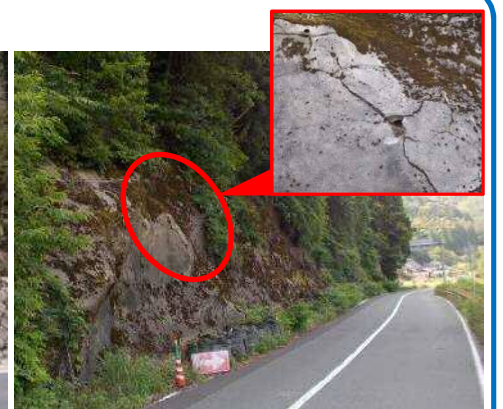
□ のり面にひび割れがある
