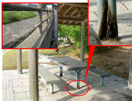
□施設が壊れている
