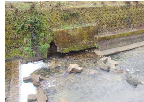
□ 護岸が崩れかけている
