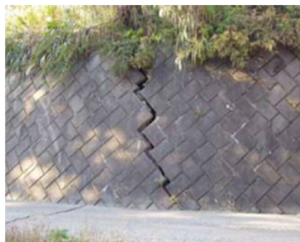
□構造物が壊れている
