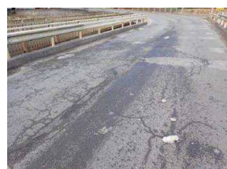
□ 舗装がひび割れしている
