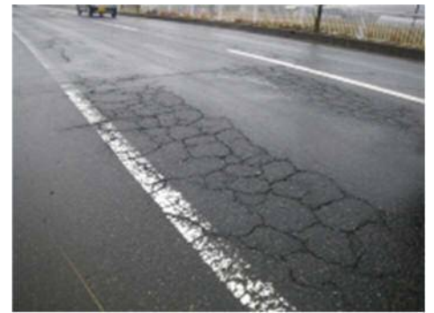
□ 舗装がひび割れしている
