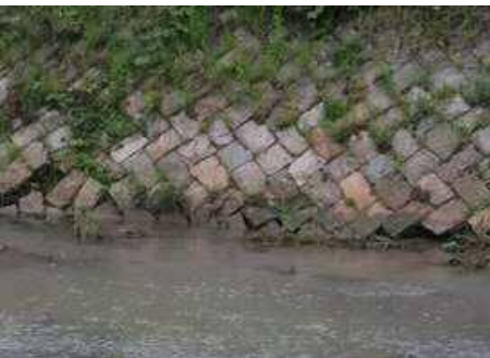
□ 護岸が崩れかけている
