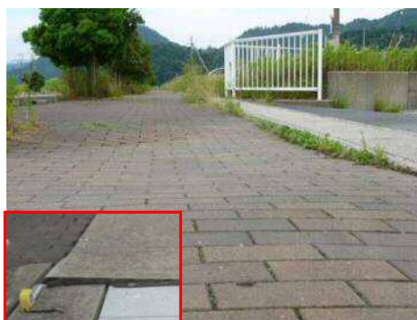
□歩道舗装が沈んでいる
