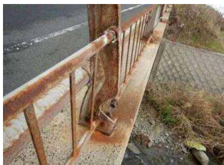
□ 柵が錆びている
