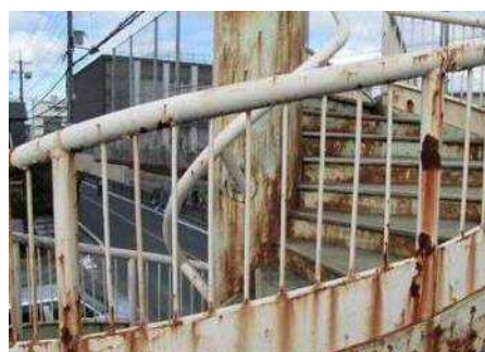
□ 歩道橋が錆びている
