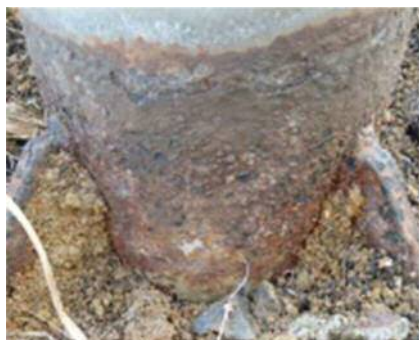
□標識柱の根元が錆びている
