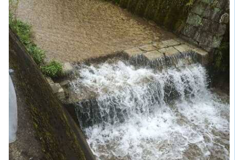
□ 構造物が一部壊れている
