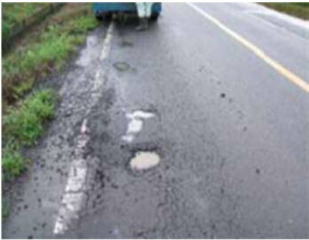
□ 舗装の一部に穴が開いている
