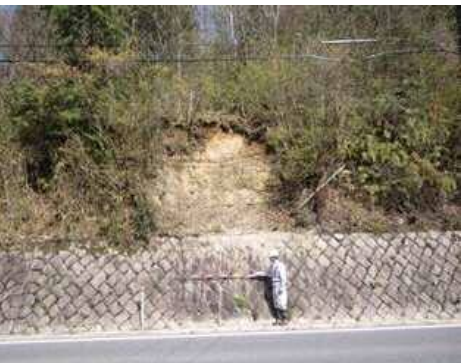
□ のり面が崩れている
