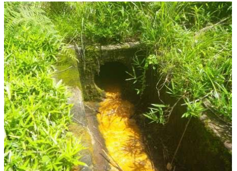
口池 漏水状況
