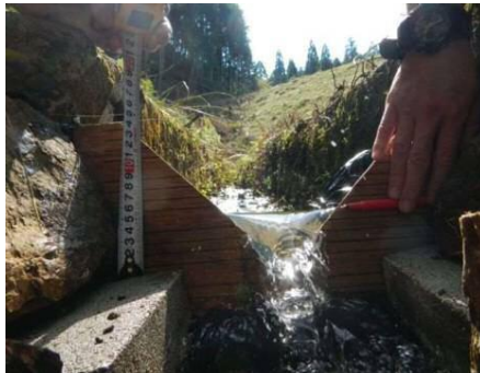
奥池 漏水状況
