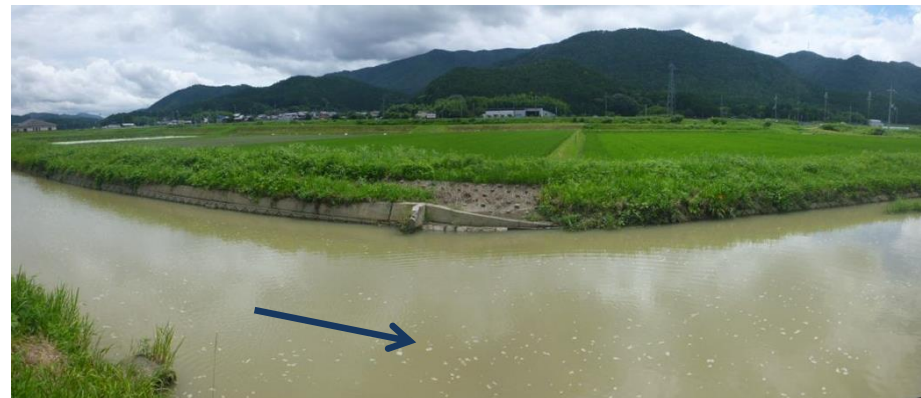
堤防天端が低くなっている部分がある(不陸)
