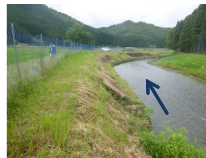
左岸張コンクリート裏の空洞
