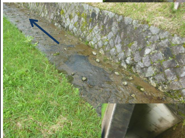
河床コンクリートの破損
