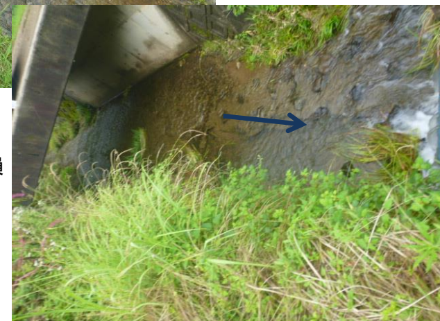
河床コンクリートの破損
