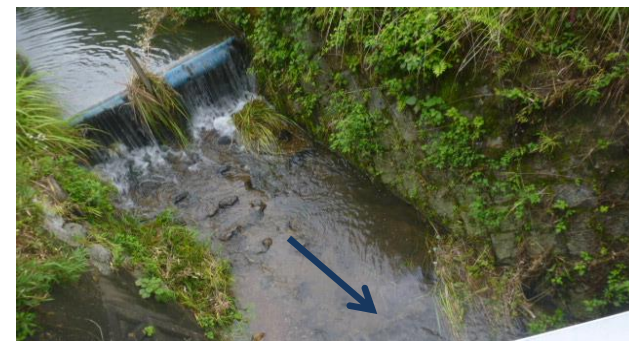
河床コンクリートの破損
