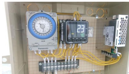
自動灌水の制御装置
