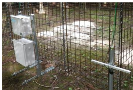
制御BOX、蓄電池、侵入センサー
