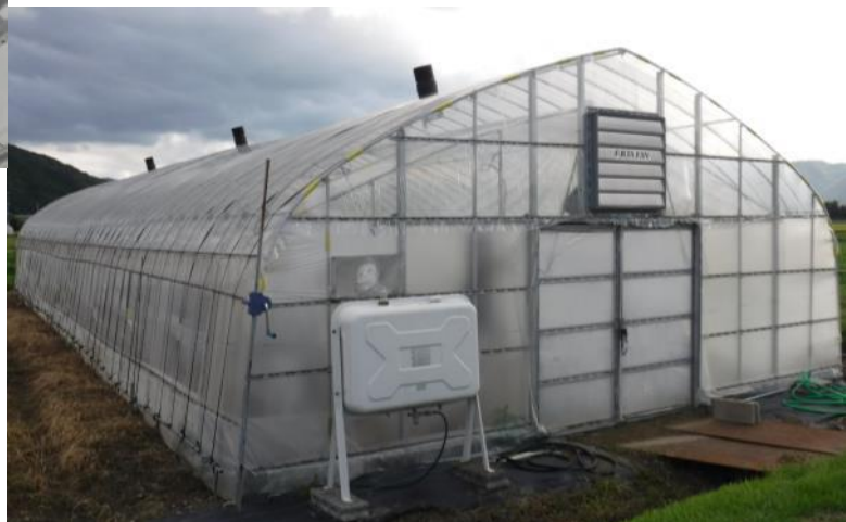
無電源の換気扇を設置したパイプハウス
