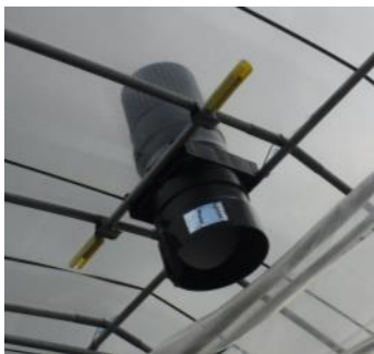
設置した無電源の換気扇
