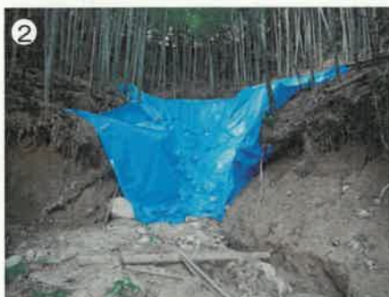
斜面崩壊状況
