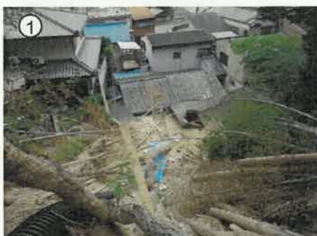
保全対象人家と斜面の崩壊状況
