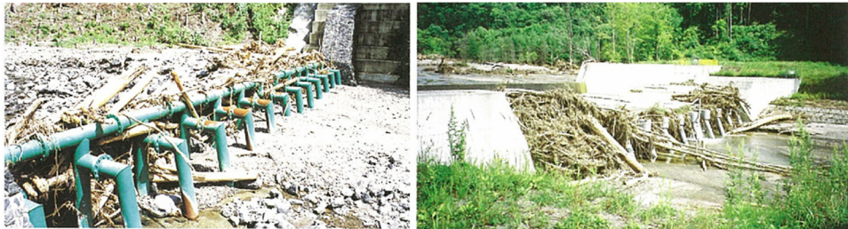
図 5-3 掃流区間に設置された流木捕捉工
