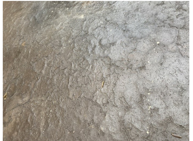
仕掛けによるひび割れ
