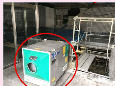
集塵機を設置し室内の換気を実施
