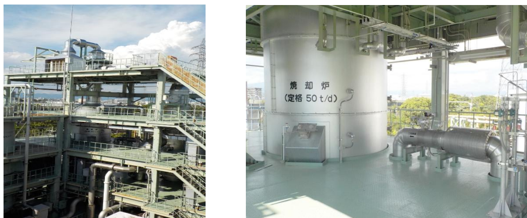
図 5.2 3号焼却炉（左：全景、右：焼却炉本体）
