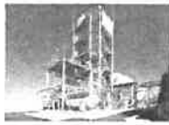
二酸化炭素分離回収施設（環境省HPより）
