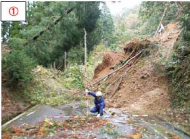
① 【場所】あやべしむつよりちょうおおいわ 綾部市睦寄町大岩 (主) まいづるわら 舞鶴和知線 【被災状況】法面崩壊 延長 60m 【復旧内容】法面工
