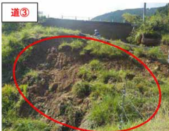
道③ 【場 所】 ふくちやまし 福知山市 (一) しものじょうかみかわぐちいでいしゃじょうせん 下野条上川口停車場線 【被災状況】法面崩壊 延長 73m (3 箇所) 【復旧内容】吹付法枠
