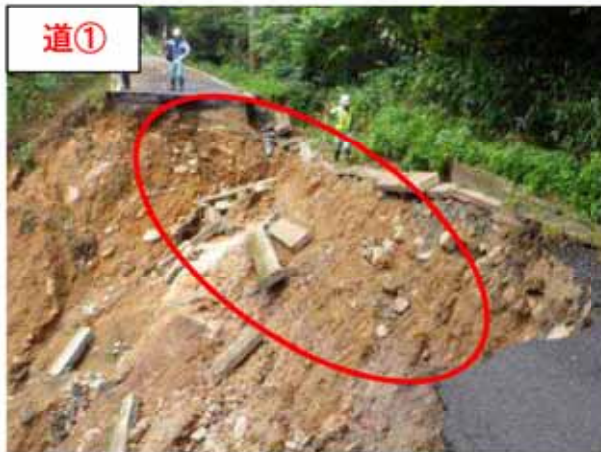
道① 【場 所】 きょうたんごし いねちょう 京丹後市・伊根町 (一) きゆうそいねせん 久僧伊根線 【被災状況】車道欠壊 延長 234m (7 箇所 7 工区) 【復旧内容】擁壁工・盛土
