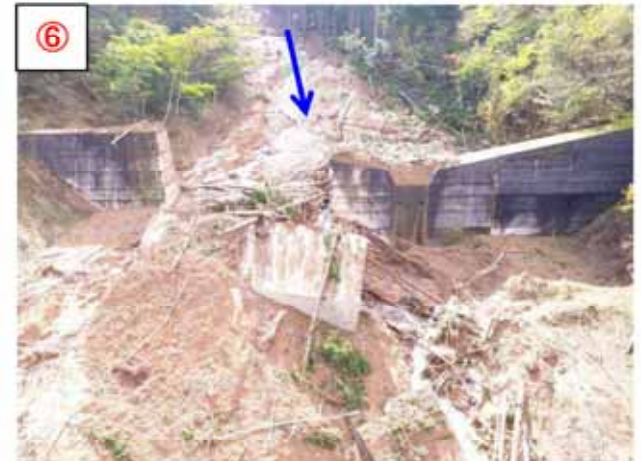
あやべしこやおかまち あさねがわ 【場 所】 綾部市古屋岡町 普通河川 朝根川 【被災状況】 砂防堰堤損傷等 延長 250m 【復旧内容】 砂防堰堤復旧工
