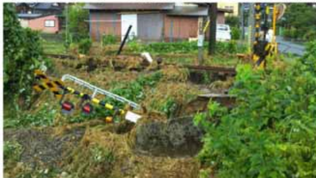
⑤ 網野～夕日ヶ浦木津温泉 【被災状況】バラスト流出、岡田第二踏切警報器倒壊
