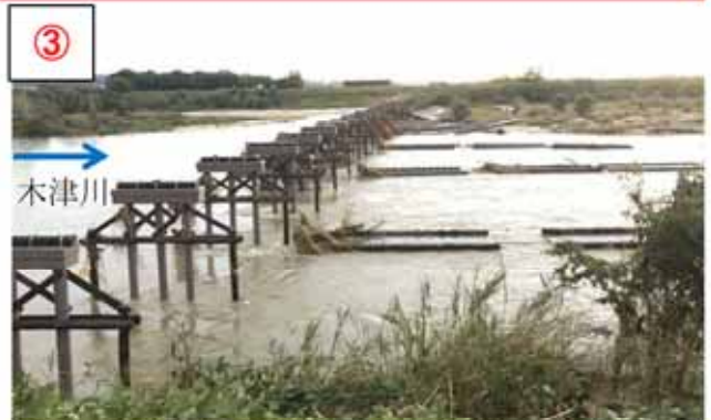
③ 【場所】やわたしこうづや 八幡市上津屋 (主) くみやまちょうさやま 久御山町佐山 (一) やわたじょうよう 八幡城陽線 【被災状況】橋梁上部工流出 延長 357m 【復旧内容】上部工再据付
