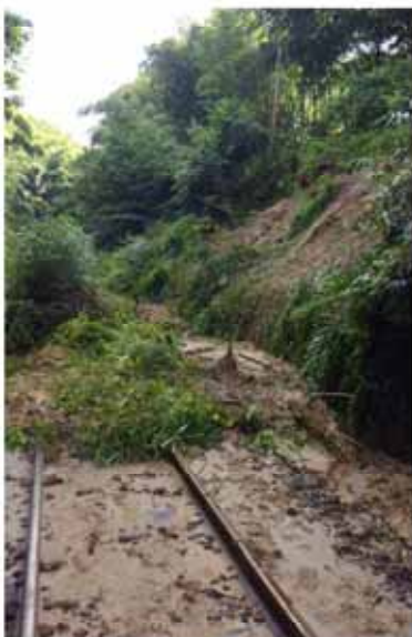
① 粟田～宮津 【被災状況】崩土 延長 120m
