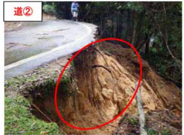
道② 【場 所】 よさのちょう 与謝野町 (一) なかふじかやせん 中藤加悦線 【被災状況】路肩欠壊 延長 20m (1 箇所 4 工区) 【復旧内容】大型ブロック
