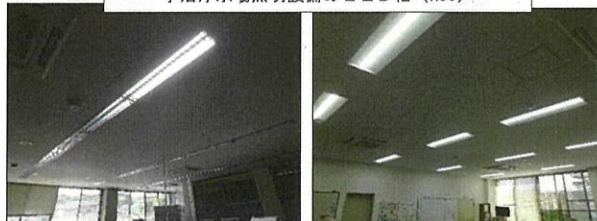
宇治浄水場照明設備のLED化(H30)
