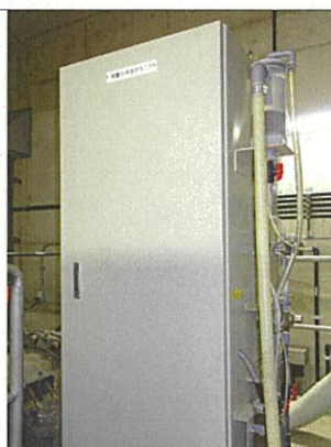
木津浄水場油臭センサー
