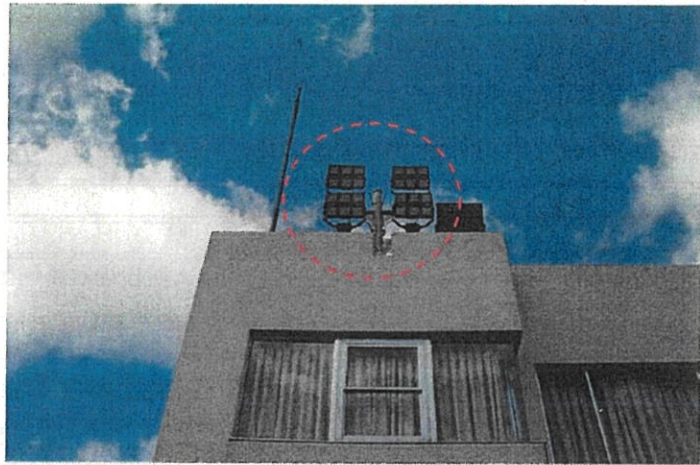
設置状況：投光器
