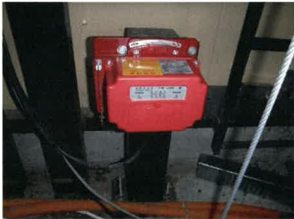
(2) 地震感知器 取付後
