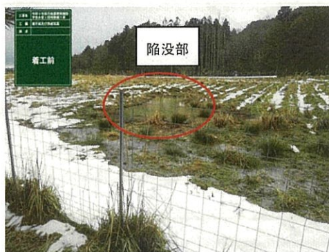
畑面陥没 【着工前】
