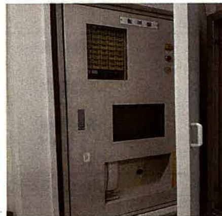
<副受信機>現況 (平成11年～不使用、撤去)
