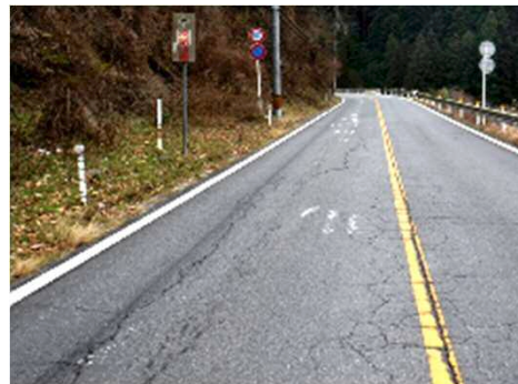
舗装のクラック
