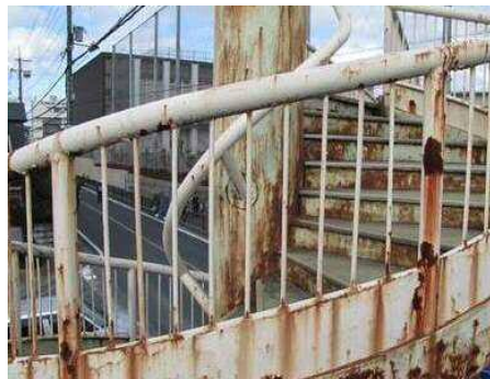
歩道橋の錆び
