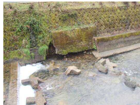
護岸の一部崩落
