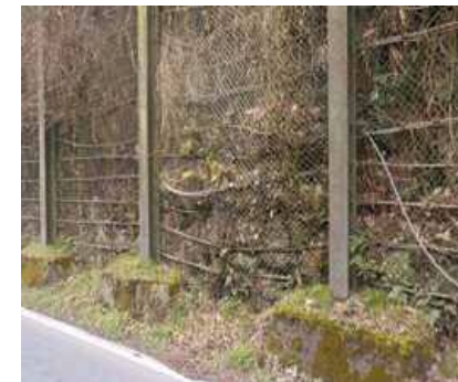
落石防護網の損傷
