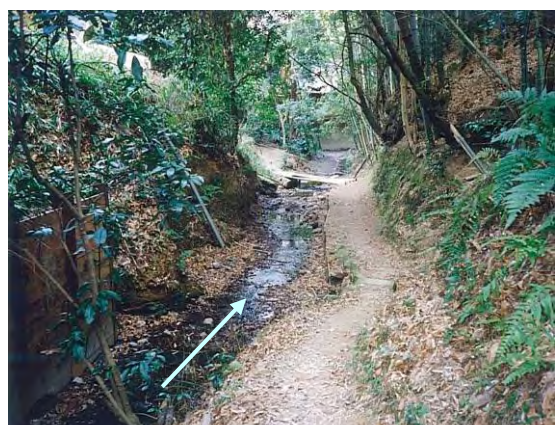
【写真－4 溪岸侵食：下流溪流】
