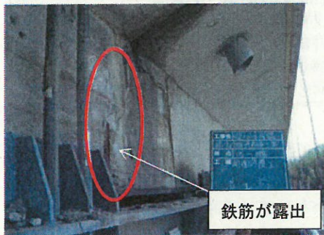
【写真A 鉄筋が露出した橋梁桁部分】
