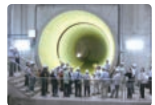
いろは呑龍ポンプ場
