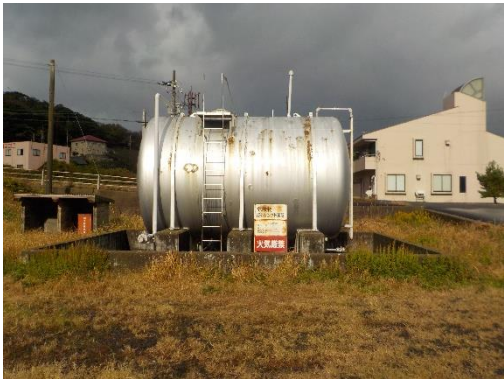
① 燃油タンク（全景写真）
