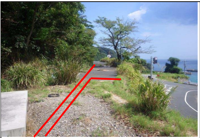
本庄地区導水管・排水管
