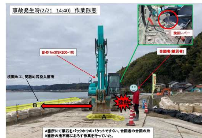
図 事故状況写真
