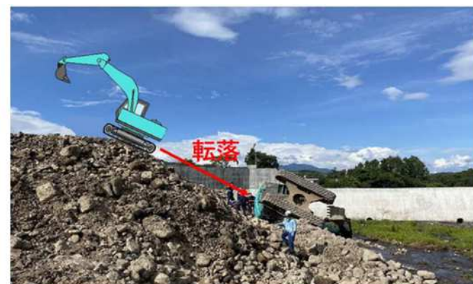
図 事故状況写真
