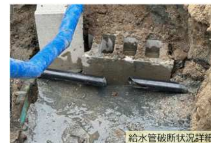
給水管破断状況詳細
