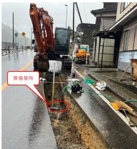
〔事故発生状況〕
