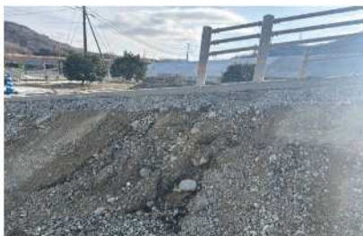
水道管損傷による 漏水写真
