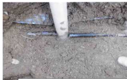
水道管損傷写真
