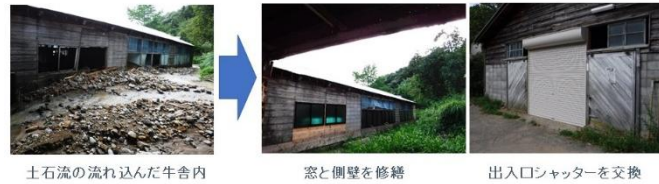
図 2.1. 土砂被害事例の事業を活用した完全復旧
