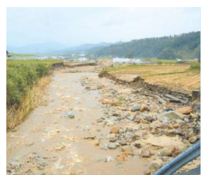
堤防が壊れた野田川では、約75haが浸水(与謝野町)
