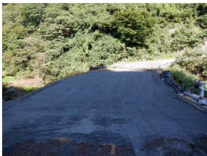
〈令和3年9月10日(復旧工事中)の状況〉 ※通行止め解除までに舗装、安全施設設置を実施
