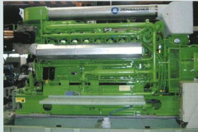
【バイオマス発電】洛南浄化センター (990kW)
