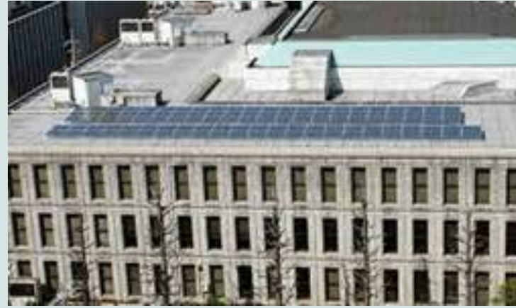
【太陽光】本庁舎 (20kW×2)
