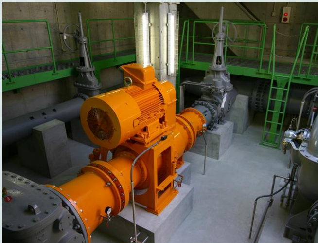
【小水力】宇治浄水場 (63kW)
