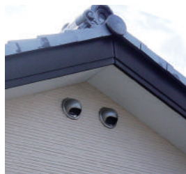
▲24時間換気システムの換気口
