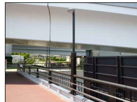
駅周辺の歩道橋部分に設置されている歩道照明
