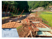
鳥獣侵入防止柵の被災(舞鶴市)
