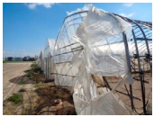
パイプハウスの被災(久御山町)
